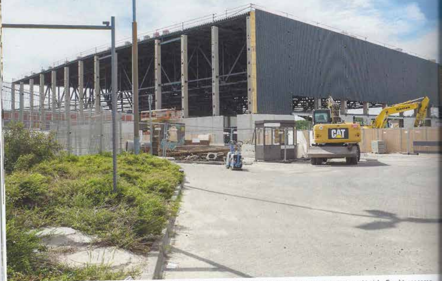
▲ Baustelle auf dem Berliner Messegelände: In der Flachdachdämmung der neuen Halle 27 platzierten die Dachdecker zahlreiche Feuchtesensoren
